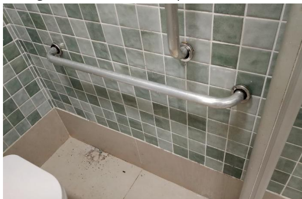
Figura 86: Conserto do apoiador acessível
