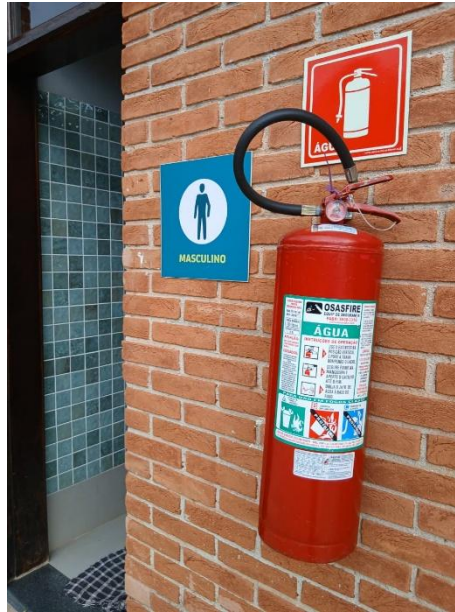
Figura 53: Exemplo de sinalização e presença de extintores
