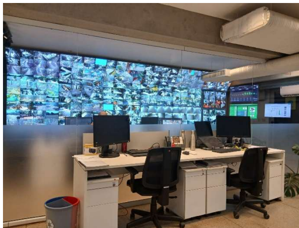
Figura 143. Centro de Controle Operacional / Monitoramento CFTV. Fonte: Registros operacionais da Urbia, 2026.
