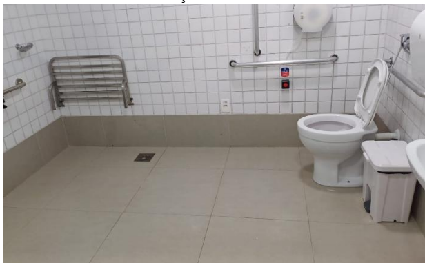
FIGURA 88 HIGIENIZAÇÃO DOS BANHEIROS ACESSÍVEIS
